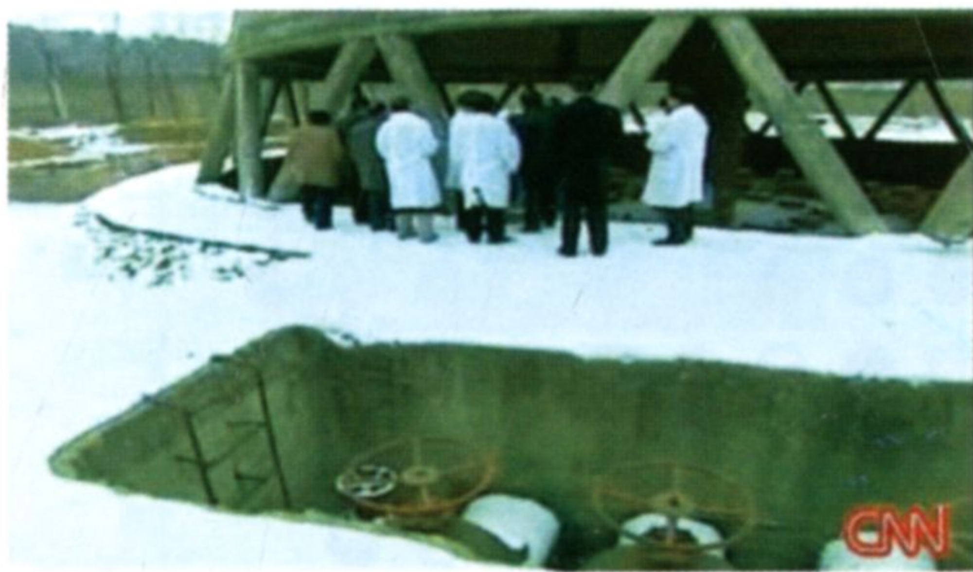
شكل (٣٨) : مواسير وصمامات ملاصقة لبرج التبريد الكوري تحت الأرض تربط بين المضخات وبين برج التبريد
