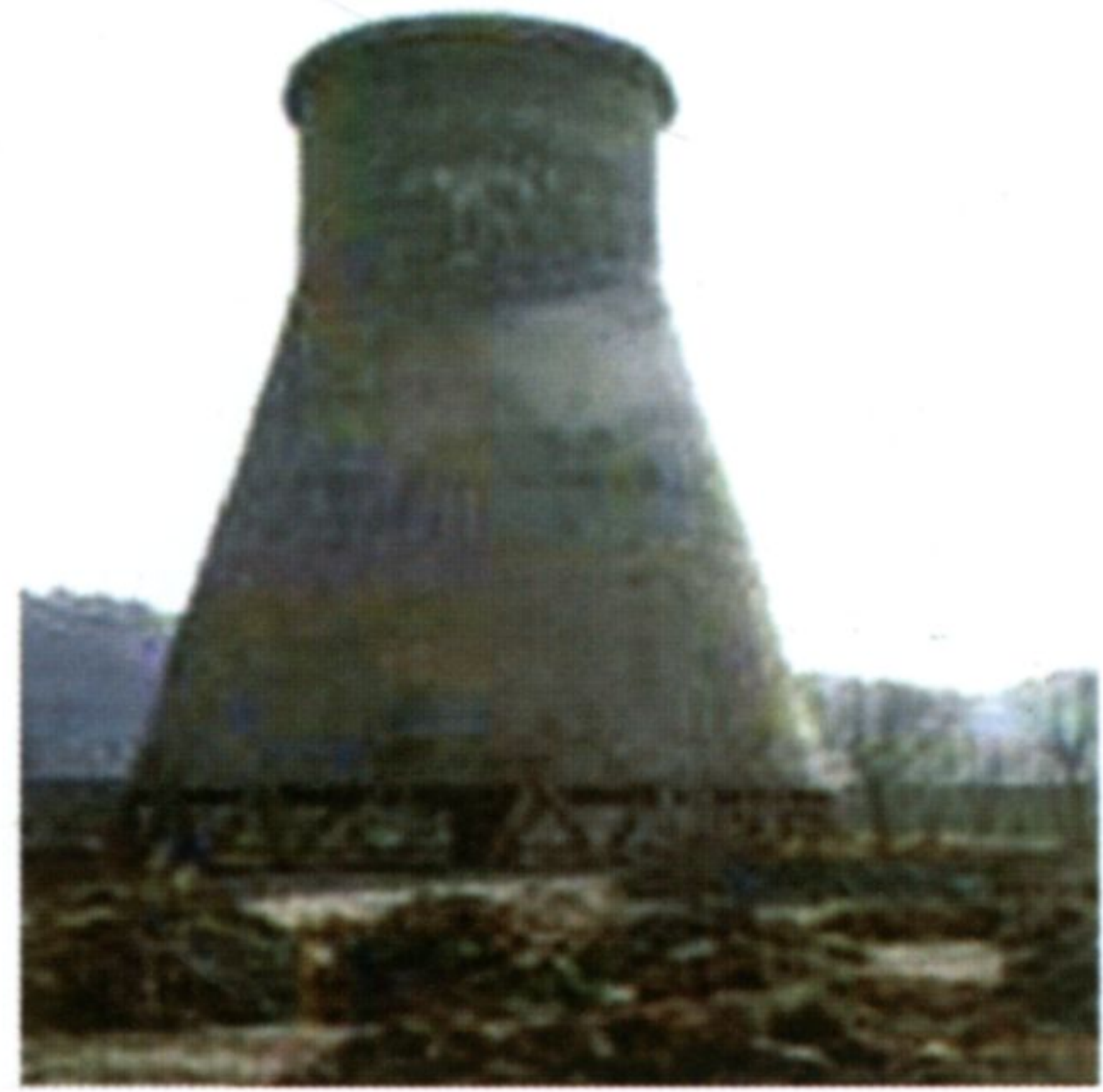
الموقع الكوري برج التبريد (ارتفاع حوالي (٤٠م)
