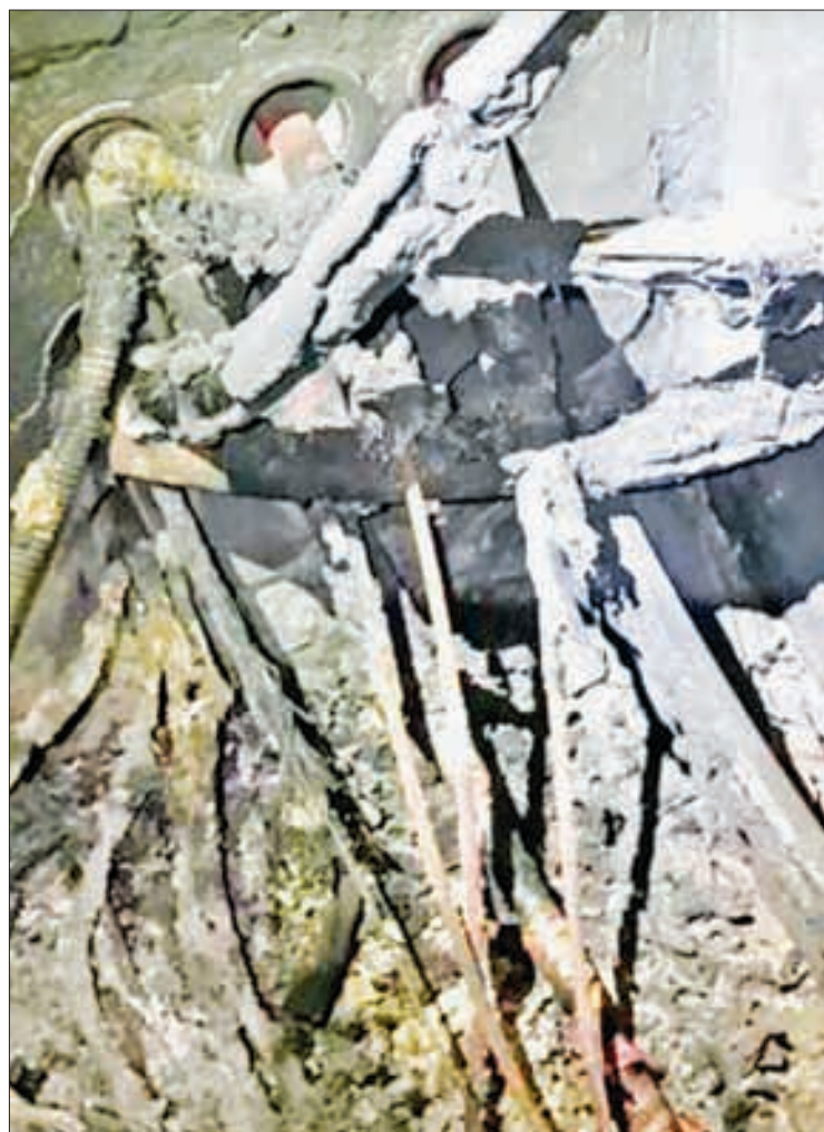
▶ Aspecto del cableado carbonizado en uno de los registros de la línea 3 del Metro en la interestación Potrero-La Raza, resultado del incidente ocurrido el 6 de diciembre pasado. Foto La Jornada
