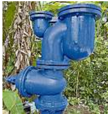
O equipamento substituído
