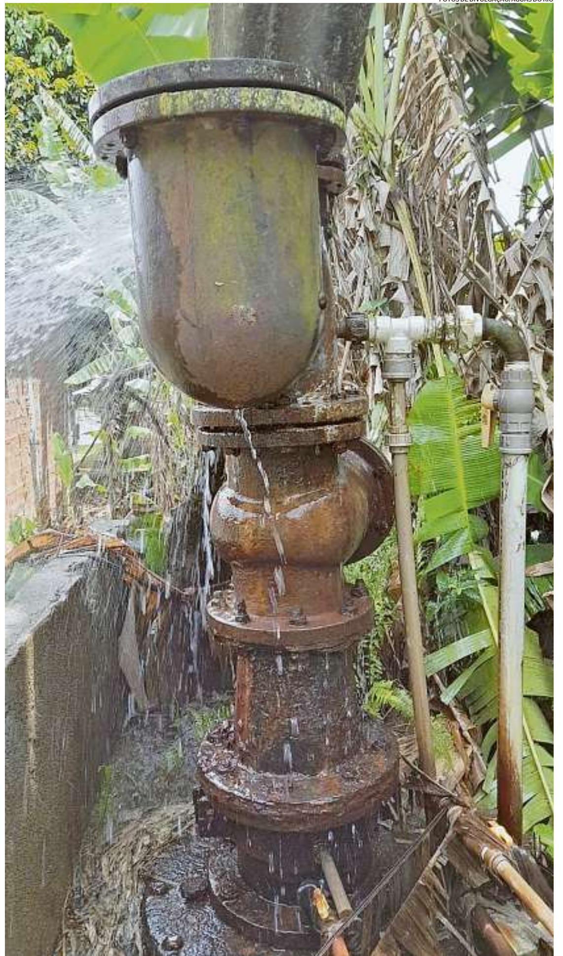
A válvula ventosa hidráulica antes do conserto da Águas do Rio, com sinais de oxidação
